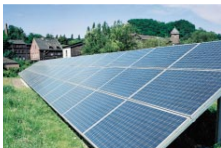
Ebenerdige Photovoltaik-Anlage mit 16 kWp Nennleistung in Mülheim a. d. Ruhr
