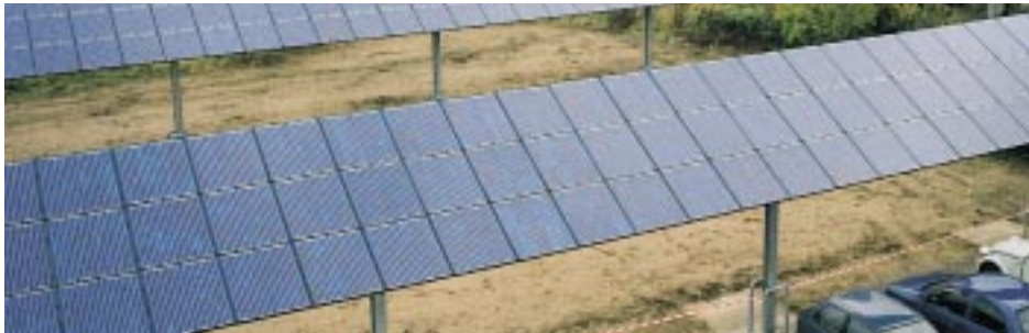
Bei der Anlage in Neuss dienen die Solarmodule als Parkplatzüberdachung
